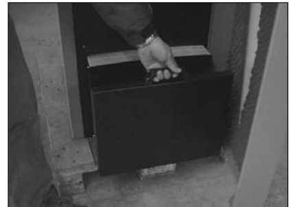
Bild C-10: Aschebehälter in Schacht schieben
